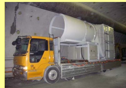
現場テスト中のトンネル工事に用いる電気集じん器
