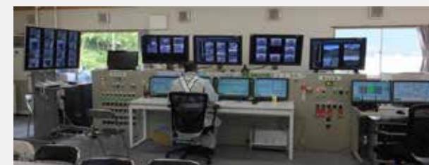
機械の運転管理を行っている中央操作室
