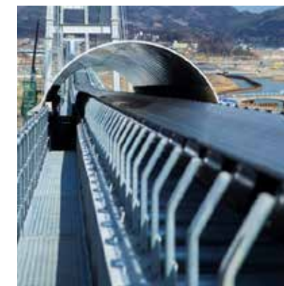
ベルトコンベア： 掘削した土砂を搬送する ベルトコンベア
