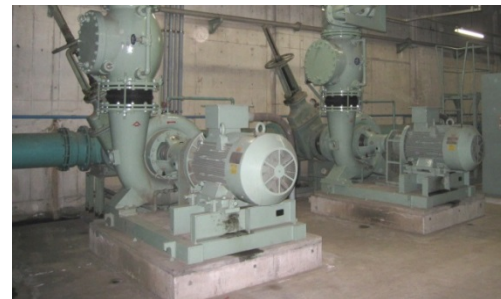
汚泥ポンププラント
