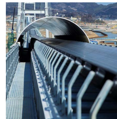
ベルトコンベア： 掘削した土砂を搬送する ベルトコンベア
