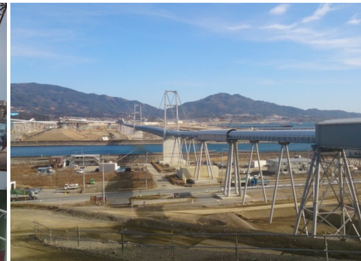
陸前高田市土砂搬送設備
