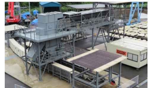
小山工場に設置した実機見学設備
