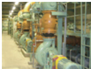
下水処理場で使用されているポンプ
