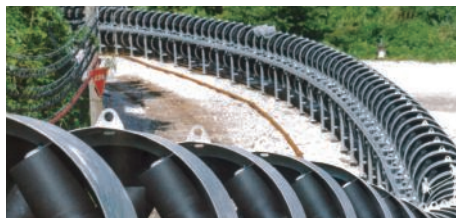
パイプコンベヤ
