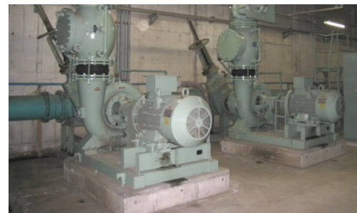
汚泥ポンププラント
