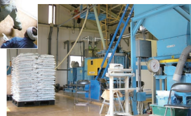
汚泥肥料化装置
