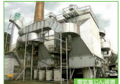
電気集じん装置
