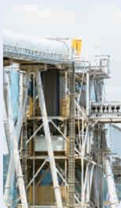
ベルトコンベア連結部
