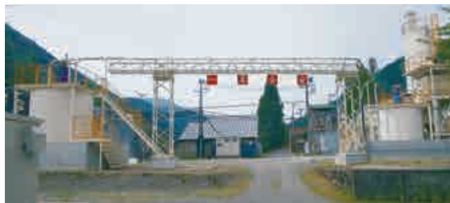
あらたに設置した石灰乳液供給施設ならびに非常用発電機
