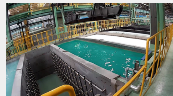
カチオン電着塗装設備 (古河ユニック(株)佐倉工場)
