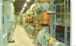
■下水処理施設のポンプ設備 全国各地の下水処理場や浄水場で豊富な実績があります。
