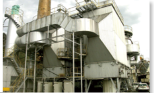
■電気集じん装置 工場などで大気汚染を防止する設備です。
